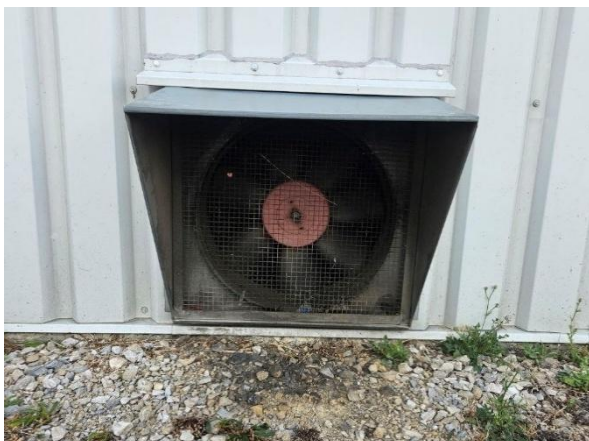
FOT. 3 Výdych vzduchu na fasáde
