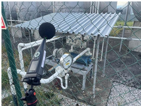
FOT. 9 Pohľad na čerpadlo
