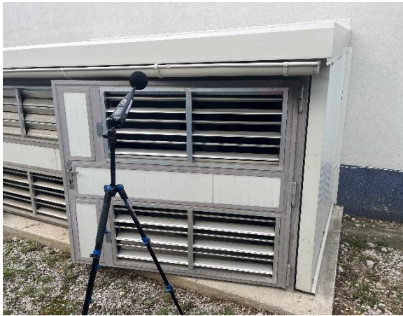
FOT. 11 Pohľad na čerpadlo
