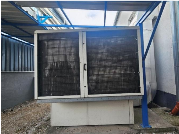
FOT. 5 Pohľad na chladiacu jednotku
