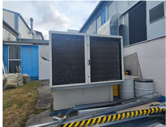
FOT. 6 Pohľad na chladiacu jednotku
